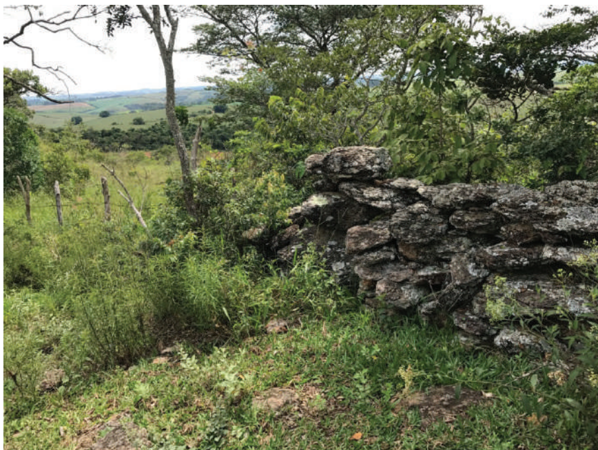
Figura 9 – Trecho de mureta de pedras.Município de Madre de Deus de Minas (MG). Foto: Rogério R. Oliveira.
